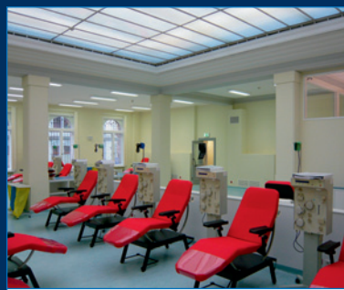
Kühlanlage im Blutspendezentrum
